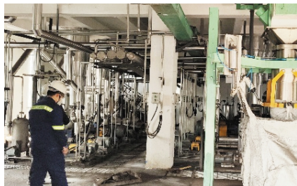
多效蒸发系统
