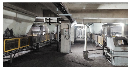
水洗脱氯系统
