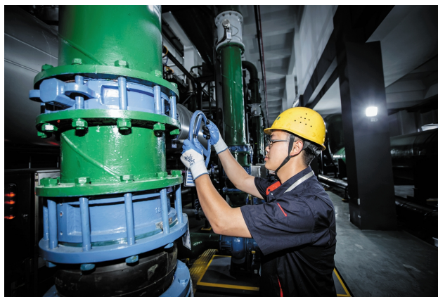
梅溪湖（雷锋）水质净化厂内工作人员正在调试设备
