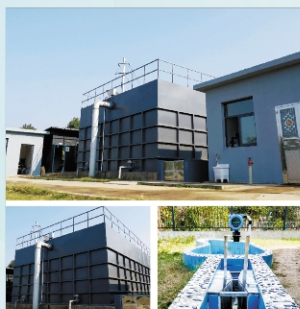
达材中学及周边集镇生活废水处理工程
